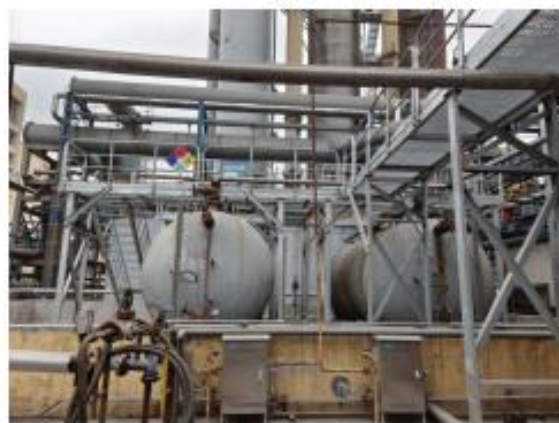
粗苯中间槽及围堰
