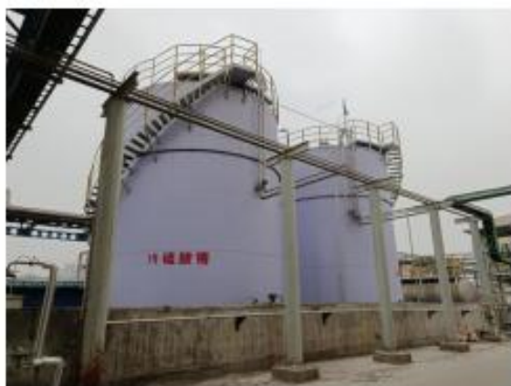
硫酸槽及围堰
