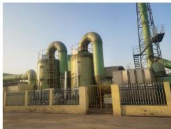
污水处理站除臭装置
